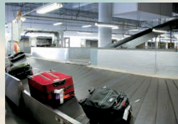
手荷物搬送設備
