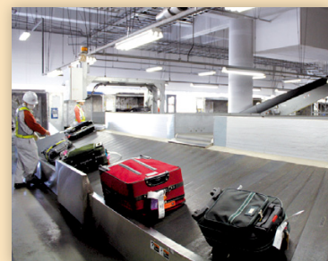
手荷物搬送設備
